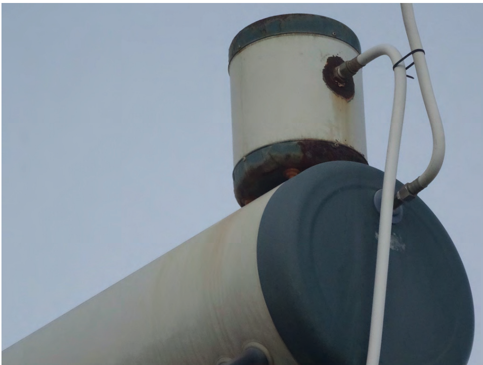
Foto 6: Nahaufnahme des obigen SWH, der Korrosionsprozess ist stark zu erkennen, Quelle: eigenes Foto
