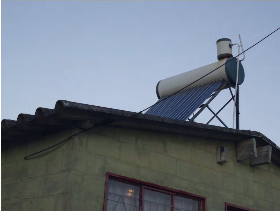
Foto 5: Low-cost Haus mit SWH der 1. Generation, Rost erkennbar, Quelle: eigenes Foto
