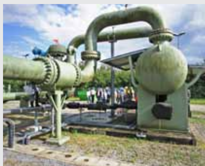
Zuleitung mit Filter (Foto: D. Hewig)
