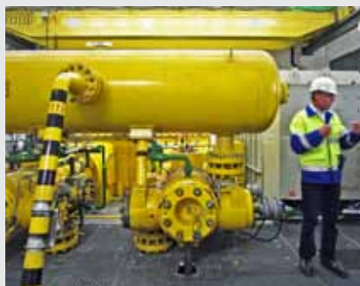
Drei Verdichter pressen das Gas ein (Foto: D. Hewig)
