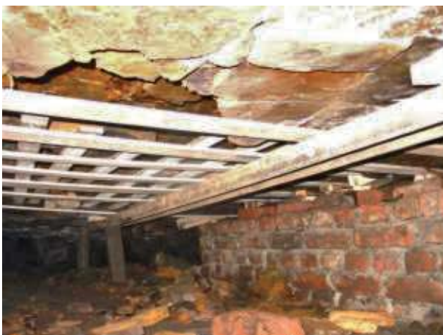
Abb. 134 Das Flacheisengeflecht zur Sicherung des Hangenden
