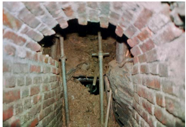
Abb. 140 Trotz Vorpfändung hereingelaufenes feines Haufwerk
