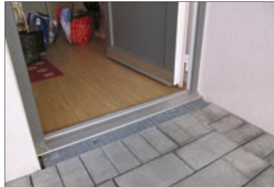
Barrierefreier Zugang durch schwellenlosen Eingang und rollstuhlgerecht angebrachte Türöffner und Spione.
