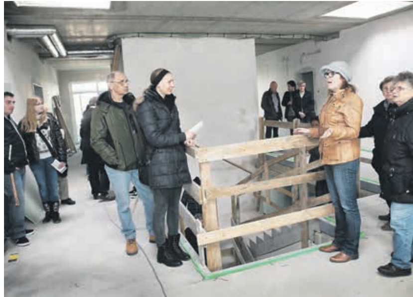
▲ Einen ersten Eindruck von der neuen Kita an der Heerdter Straße konnten sich Kinder, Eltern und Erzieherinnen, aber auch Nachbarn beim Baustellentag verschaffen.
