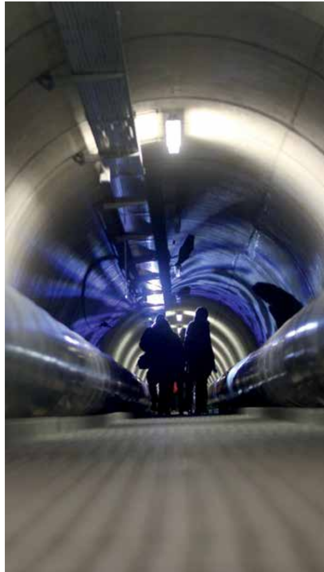
Mit effizienter Energieerzeugung und -nutzung soll NRW zum klimafreundlichen Energieland werden. Fernwärme ist insbesondere in dicht besiedelten Gebieten wie hier in Köln eine gute Option. © RheinEnergie AG
