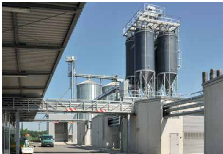
Klimafreundlicher Bestandteil der Energieversorgung im Tecklenburger Land: Biomasse-Blockheizkraftwerk (BHKW) in Ladbergen. ©EnergieAgentur.NRW
