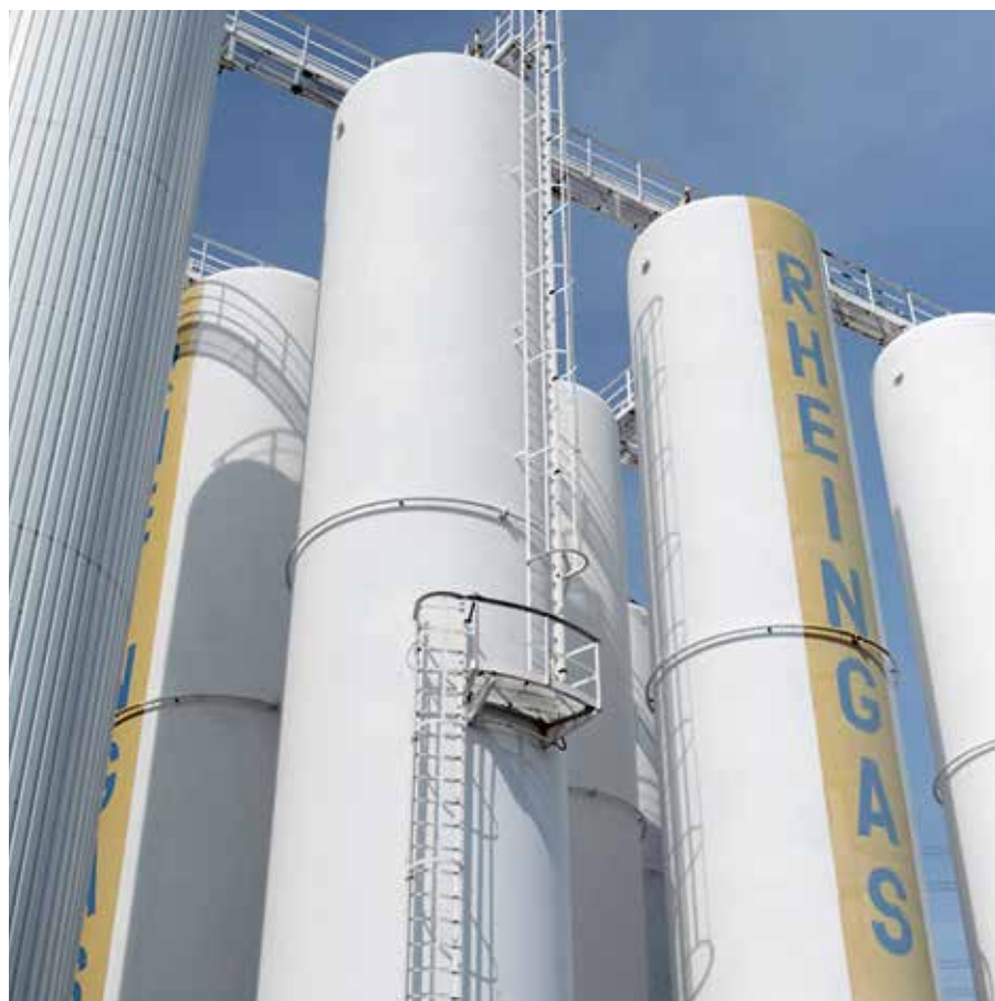
Deutschlands erste flüssiggasbetriebene Mikrogasturbine in Brühl produziert Strom, Wärme und Kälte und sorgt für eine effiziente und dezentrale Energieversorgung. ©Propan Rheingas GmbH & Co. KG
