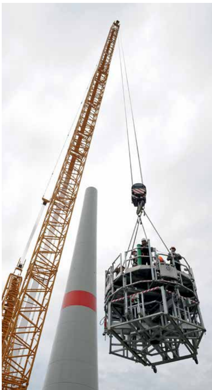
Beim „Klimaschutz von unten“ setzt NRW auch auf die Errichtung von Bürgerwindparks. ©EnergieAgentur.NRW
