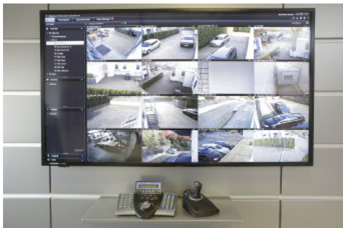
Alles im Blick: Über Monitore mit Multibild-Funktion lassen sich selbst weitläufige Gelände, unübersichtliche Gebäude und stark frequentierte Zu- und Ausfahrten gut einsehen und kontrollieren.
