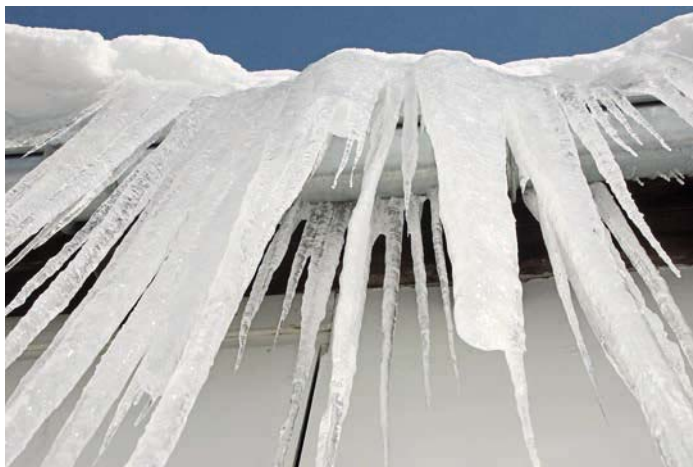
Eis- und Schneemeldsysteme - mit Steuergerät und Sensoren versehen - verhindern gefährliche Eiszapfen an Dachrinnen.
