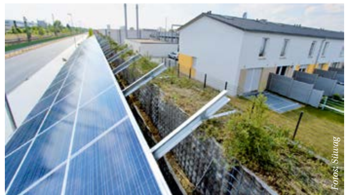
Kombination aus BHKW und Photovoltaik
