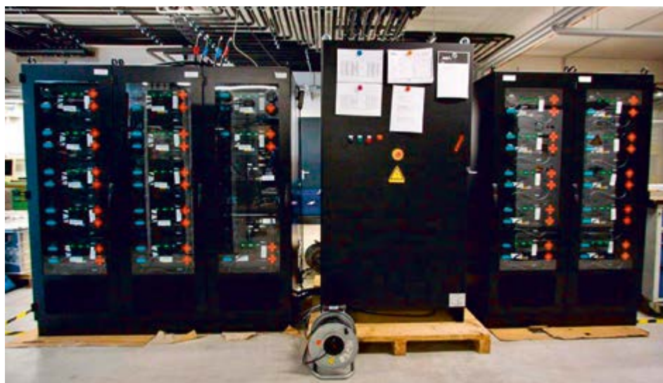
64-Kilowattstunden-Stromspeicher für das Quartier Claudius-Höfe
