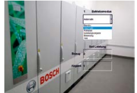
Von außen wenig spektakulär: Stromspeicher
