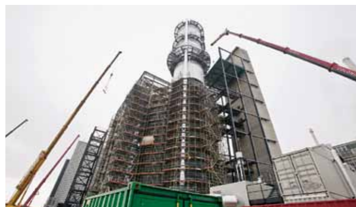
» Ab 2016 liefert der Block ‚Fortuna‘ Strom und Wärme. «
