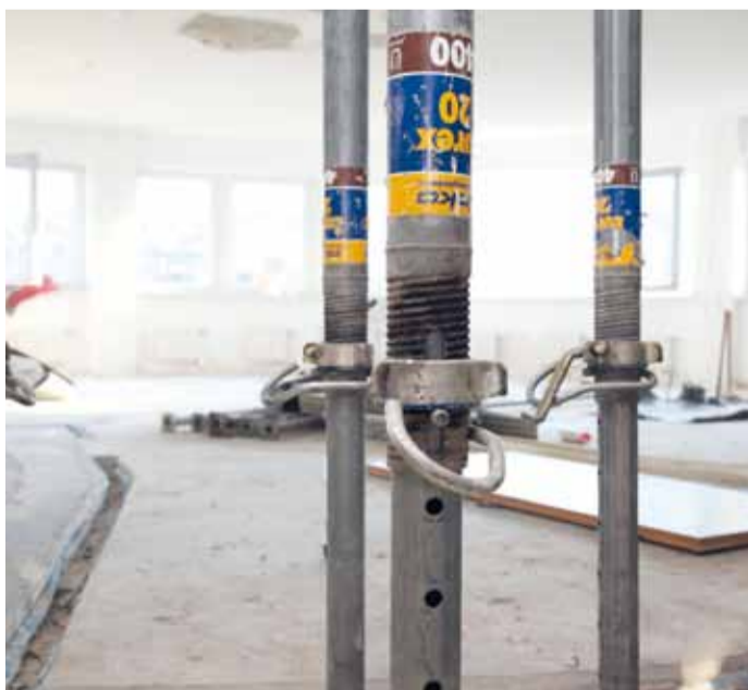
Ab voraussichtlich Mitte Dezember 2014 wird die neue Eingangszone eine wesentliche Verbesserung darstellen.
