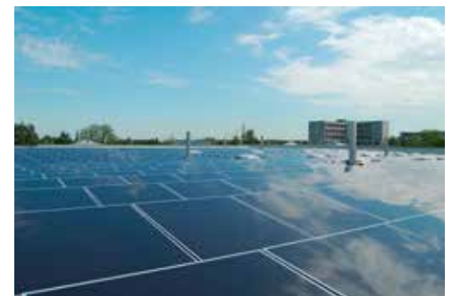
PV-Anlage im Taubental. Foto: Stadtwerke Neuss
