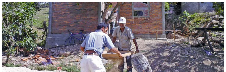
Mit viel Eigenleistung, hier Sandsieben für den Mörtel, beteiligen sich die Familien an den Bauarbeiten.
