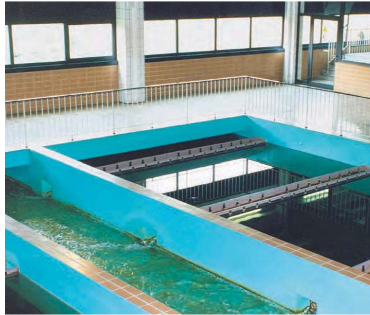
Pulsator im Wasserwerk Essen-Kettwig
