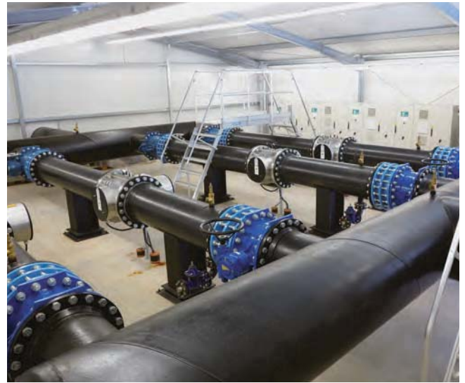
UV-Desinfektion Wasserwerk Essen-Horst
