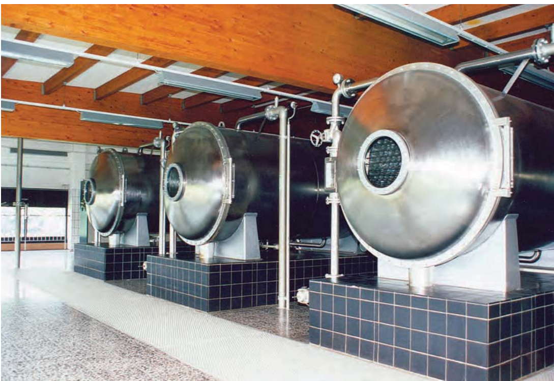
Ozonanlage im Wasserwerk Essen-Kettwig
