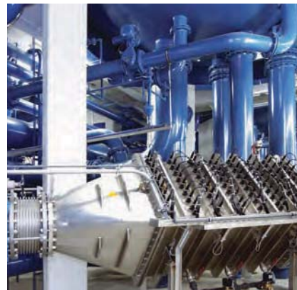
Bild oben: Filterhalle Wasserwerk Styrum-Ost
