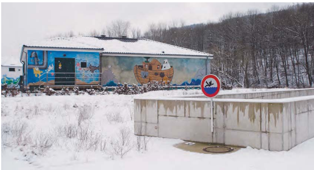
Absetzbecken für Aktivkohlespülung
