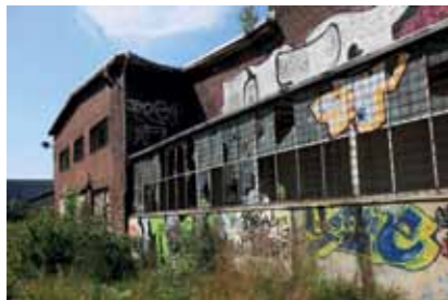
Der Eingang der alten Großviehhalle vor dem Beginn der Bauarbeiten (Aufnahme: 2008) (© Jörg Reich, FH Düsseldorf)
