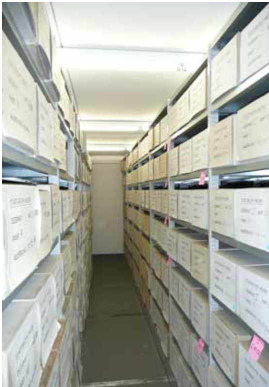
Abb. 21: Fahrregalanlage mit Beleuchtung
