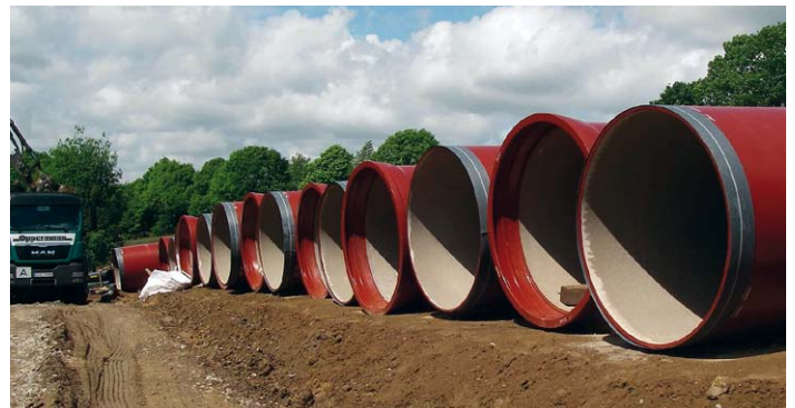
Rohr des Stauraumkanals (Quelle: BRW)
