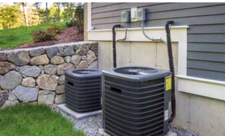
Kompressor einer Split-Klimaanlage
