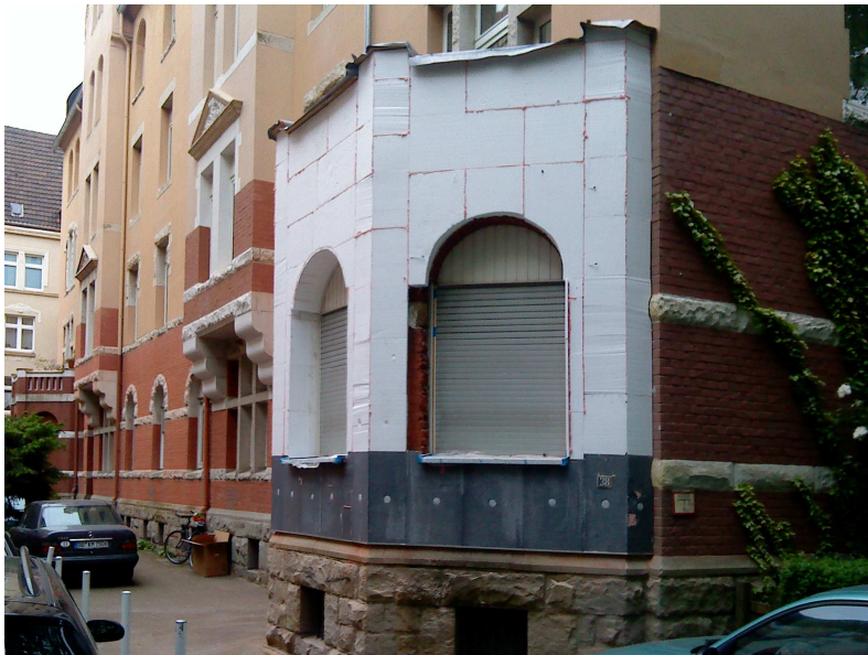
Zerstörung von Fassadendetails durch Außenwanddämmung
