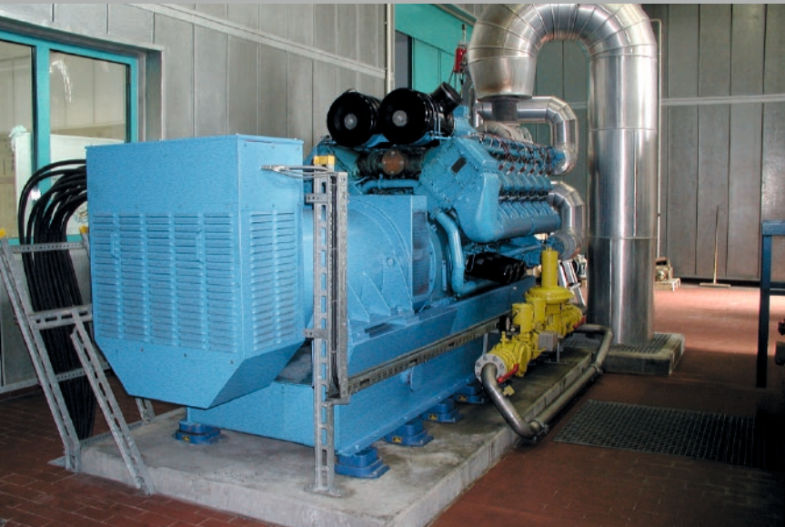
Blockheizkraftwerk der Kläranlage Duisburg-Kaßlerfeld.
