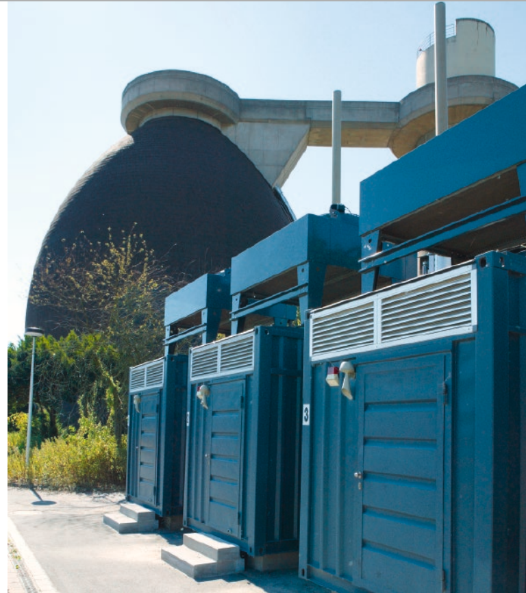
Faulbehälter und Blockheizkraftwerke (vorn) der Kläranlage Hagen.
