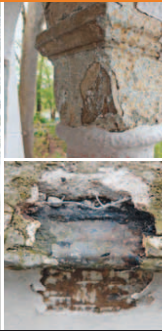
Die Schäden sind an Putz- und Mauerwerk des über 100 Jahre alten Denkmals deutlich sichtbar.
