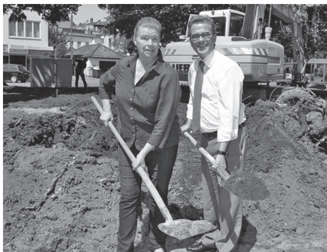
Den ersten Spatenstich zur Umgestaltung des Bismarckplatzes haben Oberbürgermeister Gregor Kathstede und die Vorsitzende der Bürgergemeinschaft Bismarckviertel, Carla Kaiser, gemeinsam vorgenommen. Bereits Ende Juni soll der erste Bauabschnitt fertiggestellt sein.
