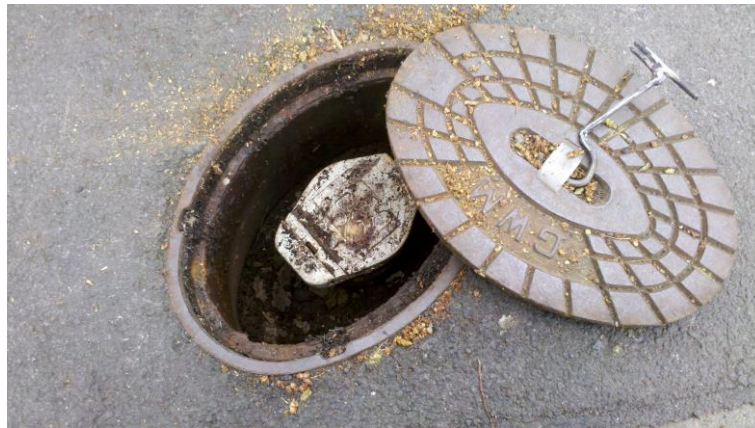
Abb. 18: Grundwassermessstelle in der Straßendecke (Quelle: LANUV NRW).
