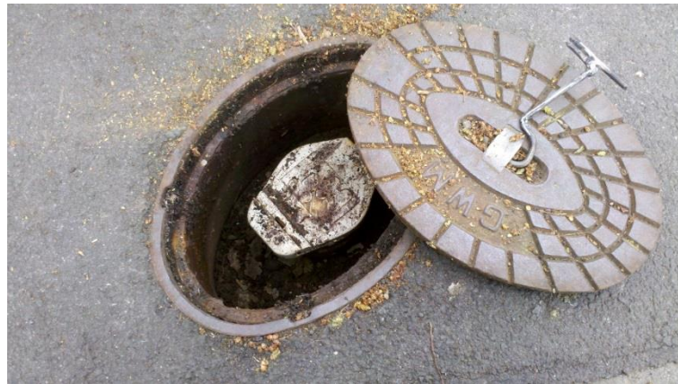
Abb. 22: Grundwassermessstelle in der Straßendecke.
