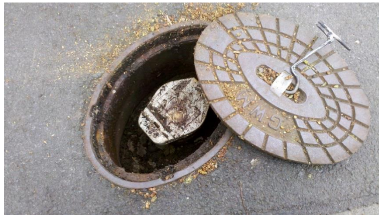
Abb. 19: Grundwassermessstelle in der Straßendecke (Quelle: LANUV NRW).
