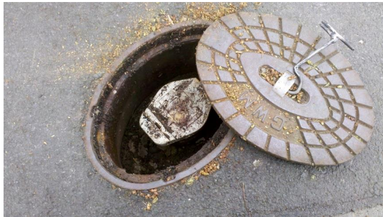
Abb. 21: Grundwassermessstelle in der Straßendecke (Quelle: LANUV NRW).
