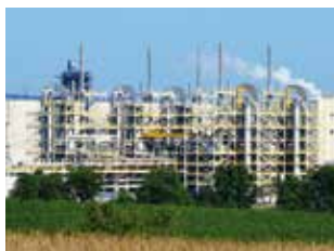
Bioethanolanlage mit „Superheated Steam Drying Technologie“
