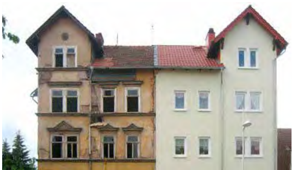
Abb. 73: Exemplarisches Beispiel für den Verlust der gestalterischen Vielfalt einer gründerzeitlichen Fassade und somit des Stadtbildes im Zuge einer energetischen Sanierung mit Außendämmung. Die unsanierte Haushälfte zeigt den ursprünglichen Bauzier an der Fassade, der bei der sanierten Haushälfte zugunsten der außen liegenden Wärmedämmung vollständig aufgegeben wurde.
