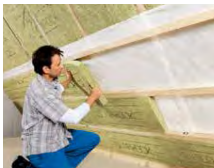
Abb. 87: Nachträgliche Dämmung eines Dachstuhls mit zwei orthogonal zueinander versetzten Dämmebenen und Luftdichtigkeitsebene
