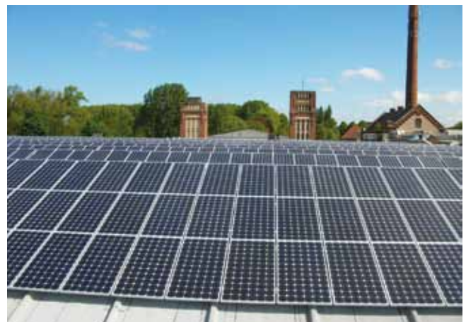
Industriehalle Rheine, 1.600 kWp
