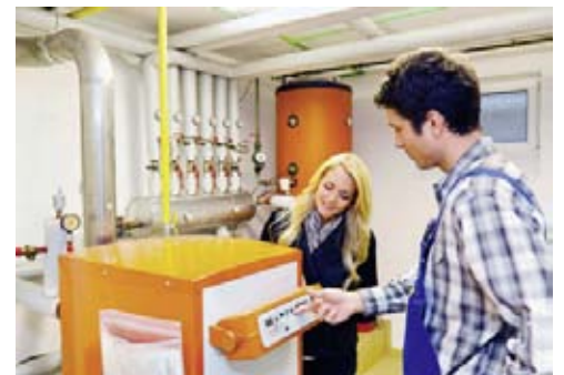
Heizkessel müssen nach rund 15-30 Jahren erneuert werden.
