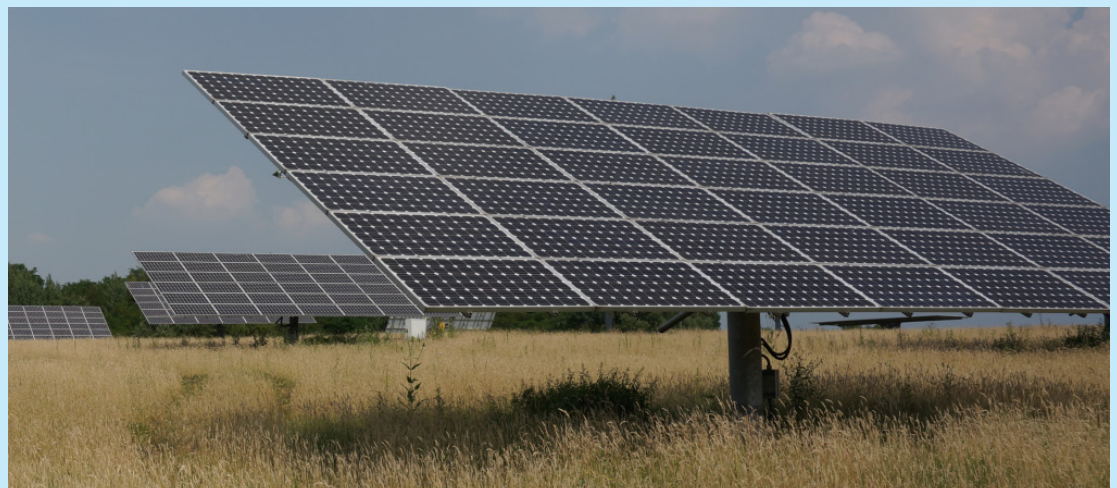
Abb. 11 Drehbare Modultische auf Einzelstützen Zentraldeponie Bottrop-Donnerberg
