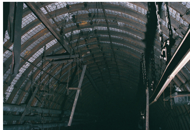
Bild 4.2 – Strecke 1.240 m vom Bohrlochfuß entfernt mit zerstörtem Explosionsschutz
