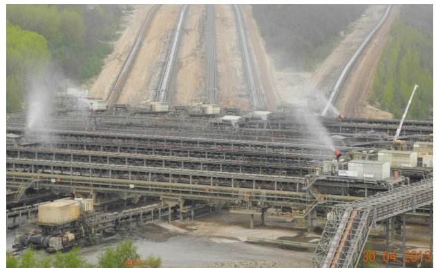
Bild 5.2 – Wasserbedüisungen und Einhausungen an den Bandübergaben.
