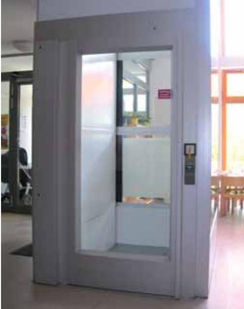
Aufzug in einer mehrgeschossigen Kindertageseinrichtung
