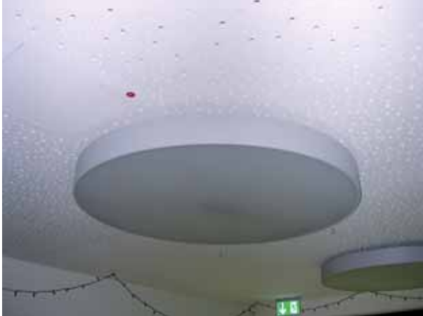
Raumakustische Decke mit Leuchtkörpern
