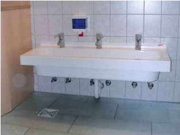
Bodenablauf unter einer Waschrinne
