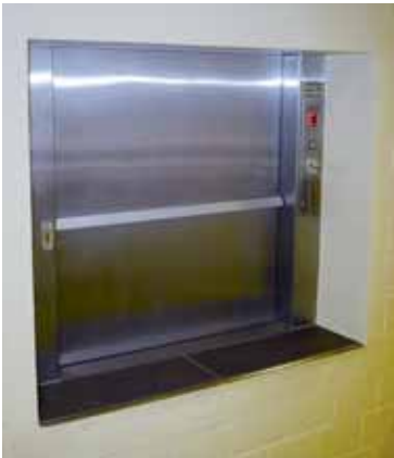
Durch Schlüsselschalter gesicherter Speisenaufzug
