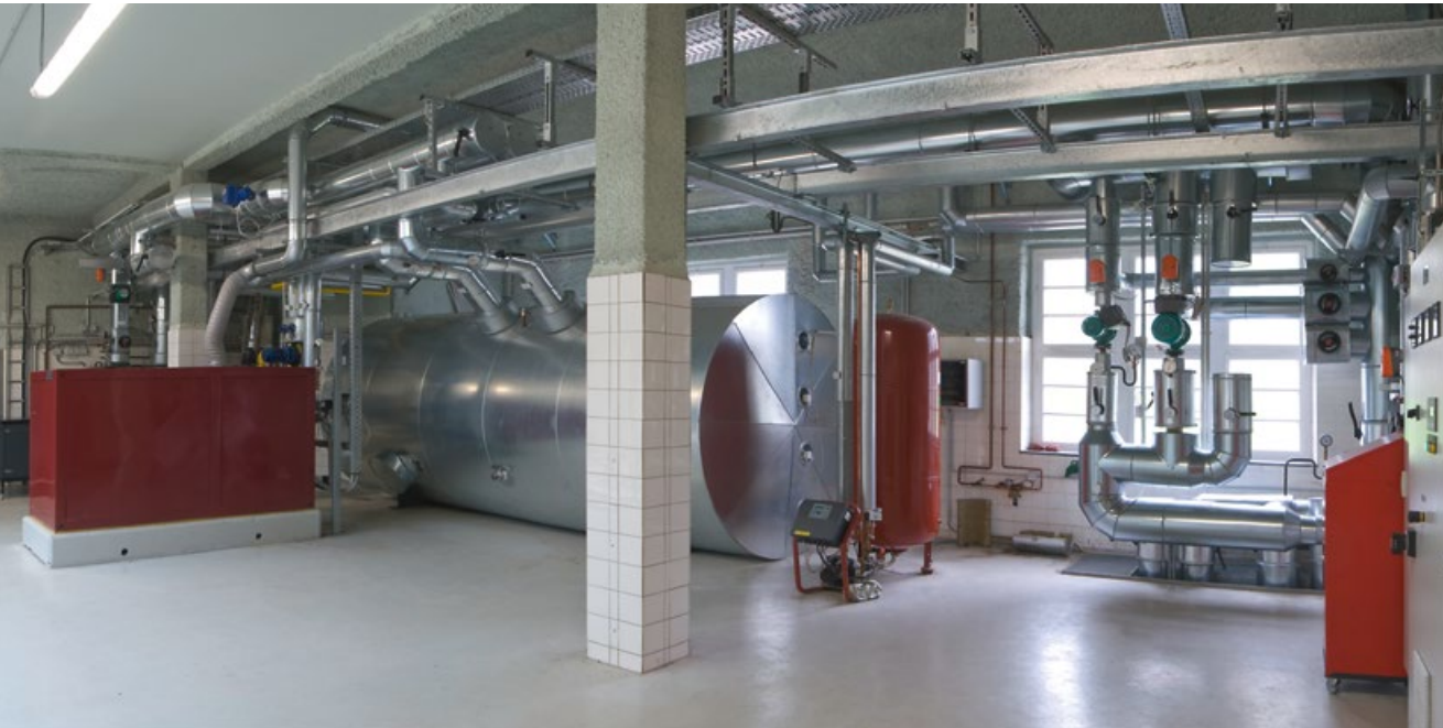
Blockheizkraftwerk Solingen Weegerhof.
