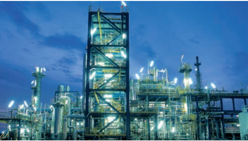
Abbildung 2.2: Wasserstoffherzeugungsanlage der Air Liquide (Quelle: AIR LIQUIDE Deutschland GmbH)
