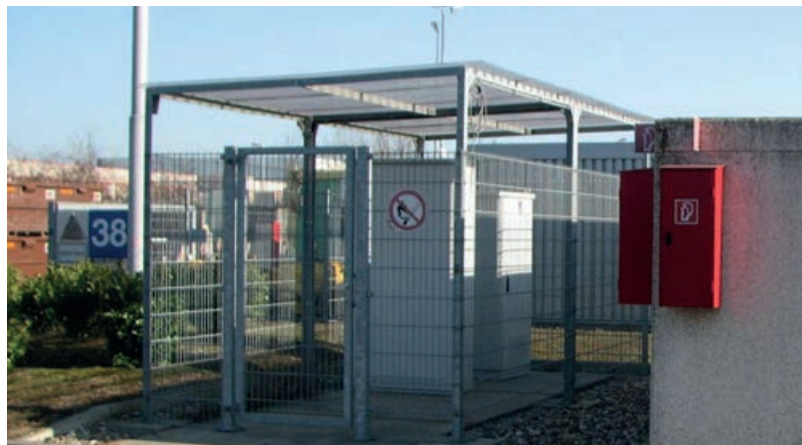
Abbildung 4.19: USV-Brennstoffzellenanlage (Quelle: Aluminium Norf GmbH)
