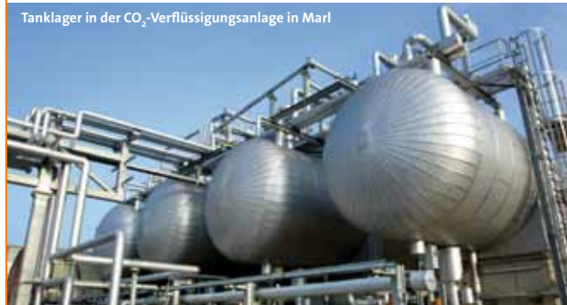
Tanklager in der \text{CO}_2 -Verflüssigungsanlage in Marl
