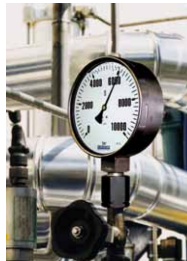
Hochdruckmeßgerät in einer LDPE-Anlage
