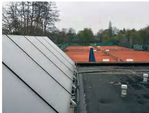
Solaranlage auf dem Vereinsheim
