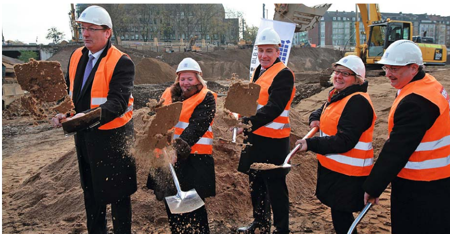
Oberbürgermeister Dirk Elbers, FH-Präsidentin Prof. Dr. Brigitte Grass, BLB-Niederlassungsleiter Düsseldorf Hans-Gerd Böhme, Wissenschaftsministerin Svenja Schulze und Dr. Reginbert Taube vom BLB NRW machten mit dem Spatenstich den offiziellen Auftakt zum Bau der neuen Hochschule am Campus Derendorf.
