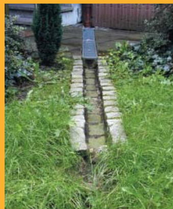
Die Pflege offener Versickerungsanlagen beschränkt sich auf einige kleine Maßnahmen
