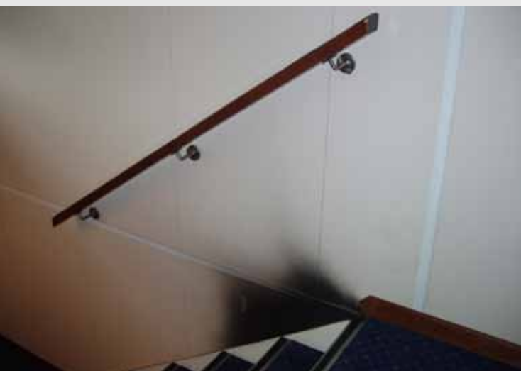
unten: Rauchspuren im Bereich der Fluchtwege
