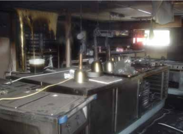
Feuerübergreif auf die Kombüse, gut sind die geschmolzenen Lampen zu erkennen.
