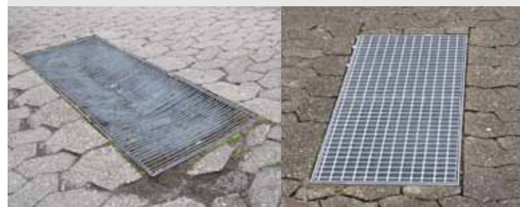
unten: Bei einer Überprüfung wurde ein einfaches Gitterrost (li.) mit Beschädigungen festgestellt. Dieses wurde gegen ein stabiles Gitterrost (re.) ausgetauscht.
