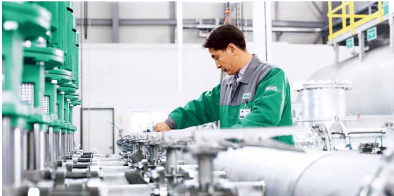
Wilo-Mitarbeiter testen und überprüfen regelmäßig die Druckerhöhungsanlagen.
