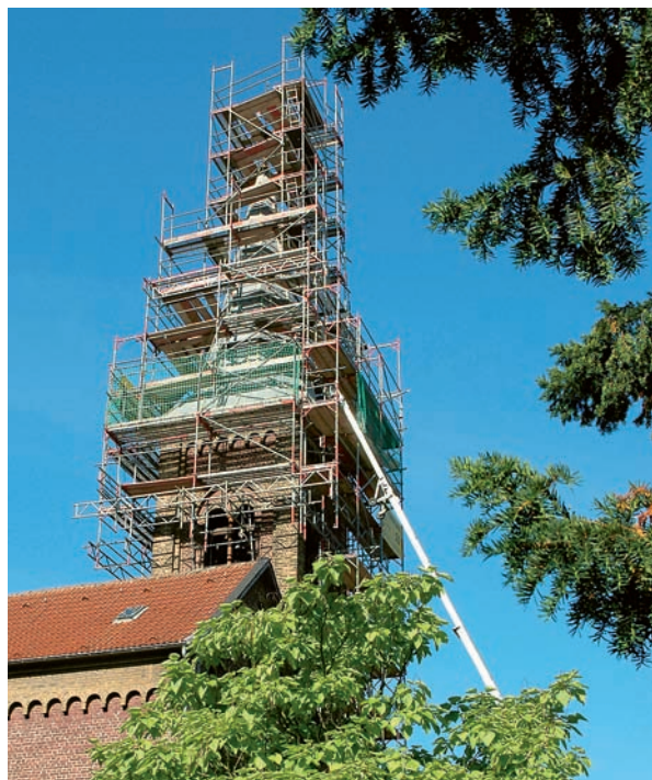
Schäden im Mauerwerk: Die Stammhauskirche aus dem Jahr 1843 muss saniert werden.
