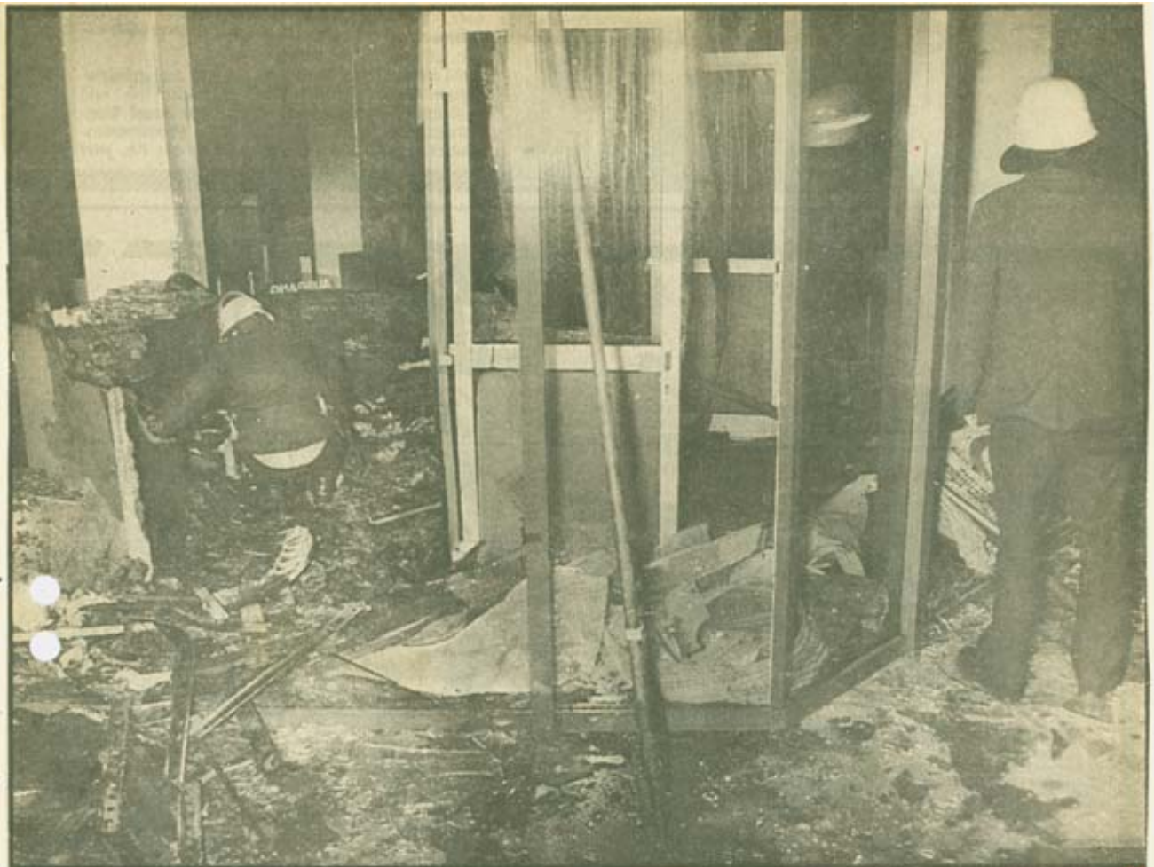
Die Filiale der Stadtparkasse im Immermannhof-Center am Hauptbahnhof: Nach dem Brand nur noch ein einziges Trümmerfeld.
