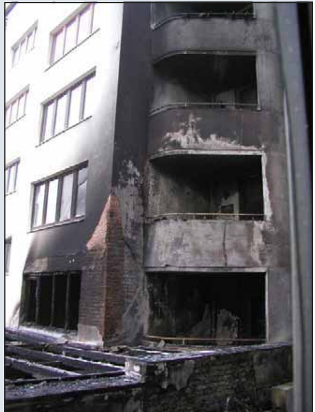
Bild unten: Die Brandausbreitung auf das 1. und 2. Obergeschoss sowie Schäden bis ins 5. OG des angrenzenden Wohn- hauses an der Luisenstraße
