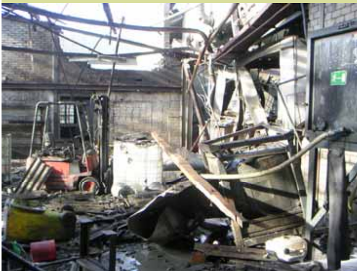
Bei der Explosion an der Kappler Straße entsteht hoher Sachschaden.
