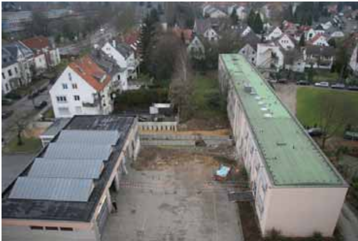
An der Wache 8 wurde ein Verbindungsbau zwischen Fahrzeughalle und eigentlichem Wachgebäude abgerissen...
