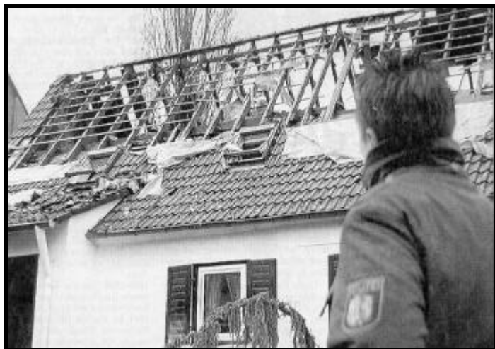
Blick auf das zerstörte Dachgeschoss des Einfamilienhauses
